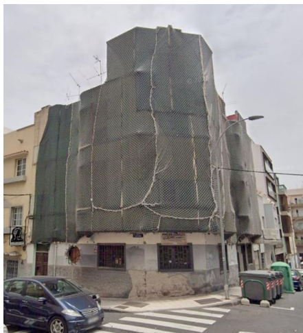
Fachada de edificio oculta por medio de malla de protección contra desprendimientos en la Calle Luis Vives, 8
