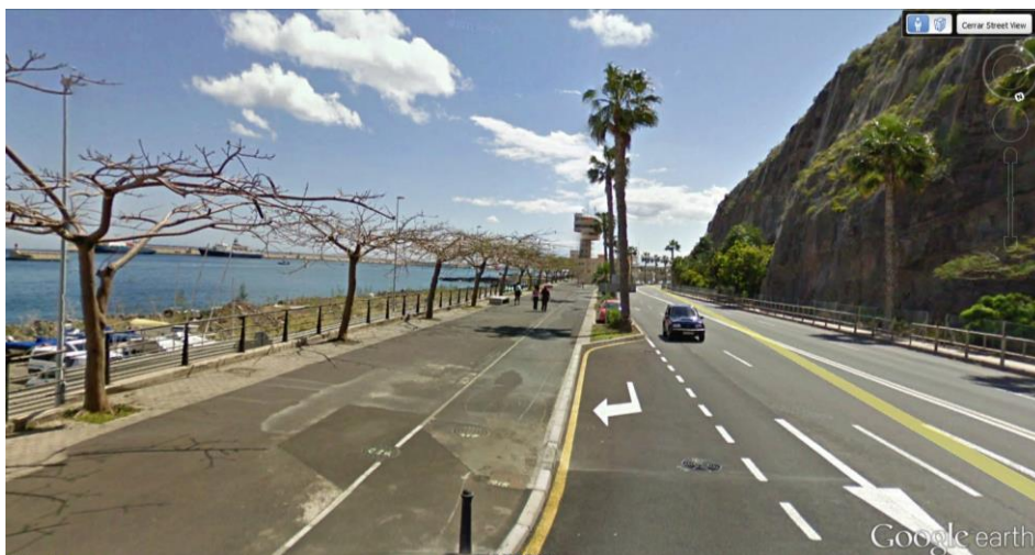
Imágenes donde se aprecian las mallas instaladas en el tramo de la TF-11 más cercano al ámbito de la Mod. del PE
